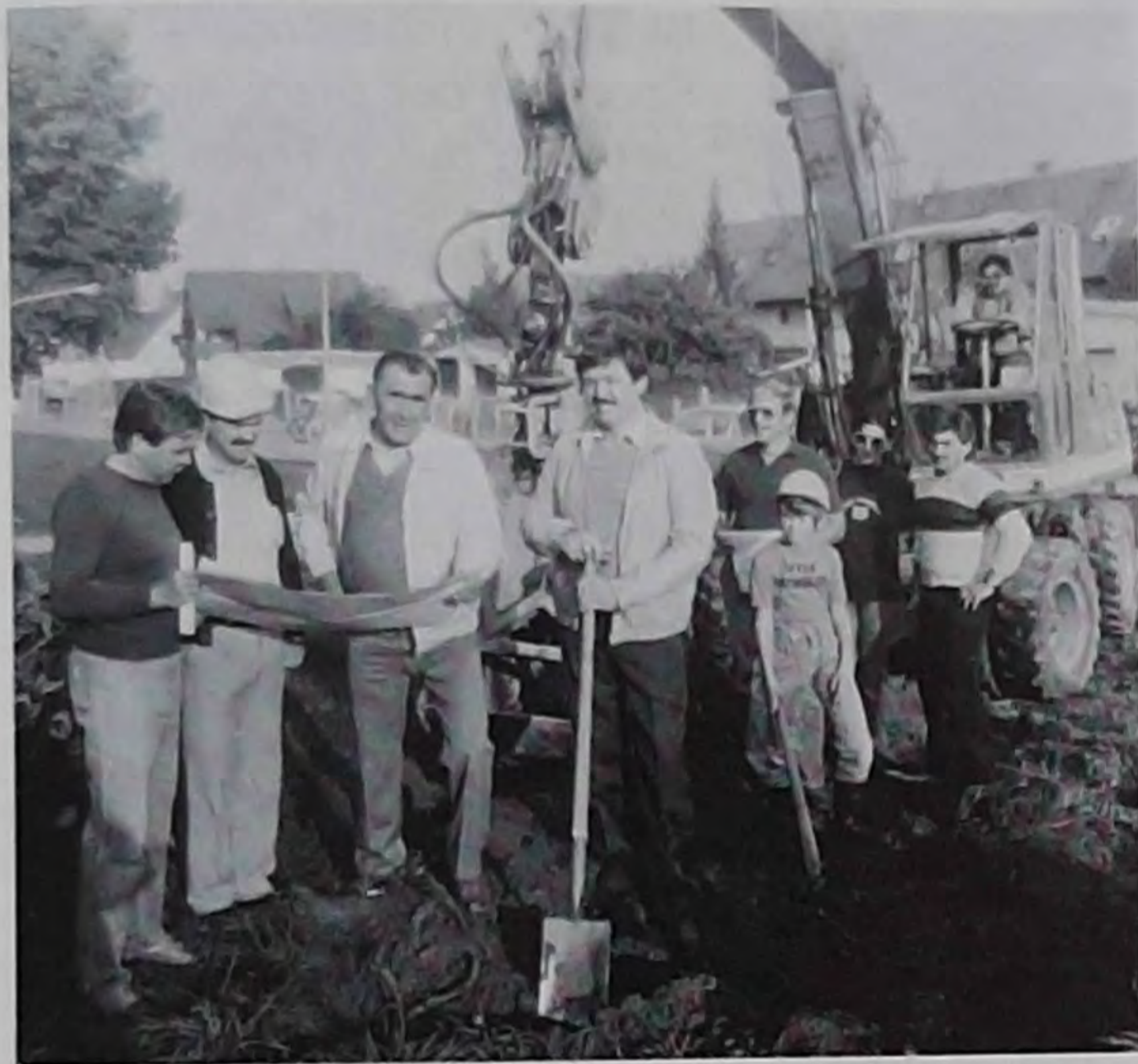
Erster Spatenstich für das erweiterte Vereinsheim (am Samstag, den 25. September 1982 durch den 1. Vorsitzenden Josef Weithaler
